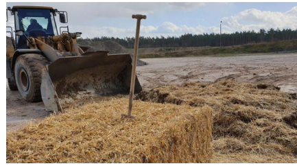
Mischen der Wellerlehm-masse aus Lehm und Stroh, hier mittels Radlader in einer Kiesgrube in der Prignitz. Foto Dieter Günnewig
